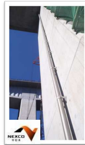
中日本高速道路株式会社 様 2009年度より 排水管に採用
